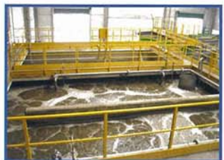
▲ Foto 7 - Depuratore biologico
