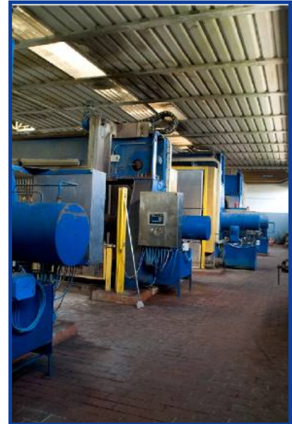
Unità di filtropressatura fanghi
